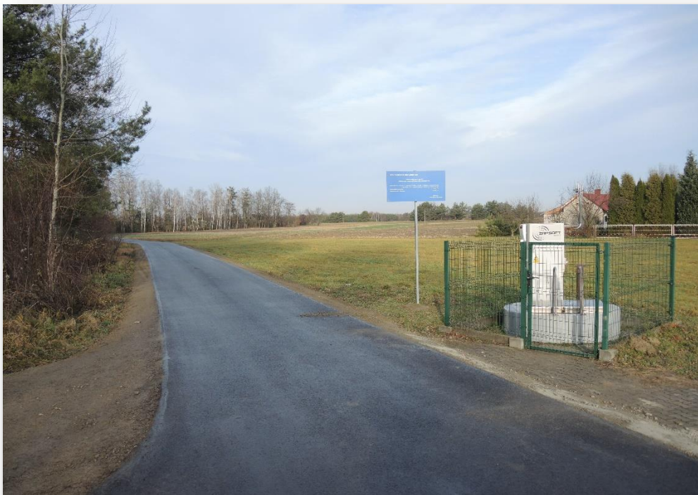
Remont drogi gminnej nr 10 34 62R w miejscowości Padew Narodowa, długość drogi 862 mb, ul. Polna
