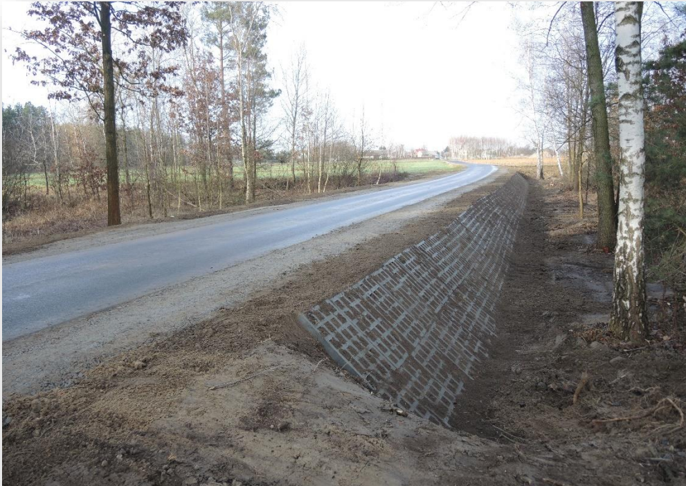
Remont drogi gminnej nr 10 34 62R w miejscowości Padew Narodowa, długość drogi 862 mb, ul. Polna
