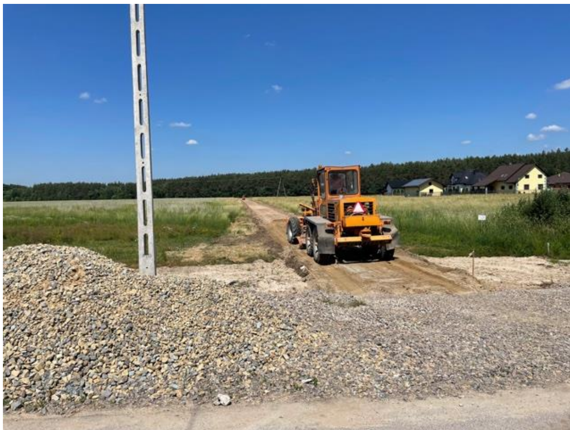
Prace dot. utwardzenia drogi na osiedlu Polska Wieś III w Padwi Narodowej
