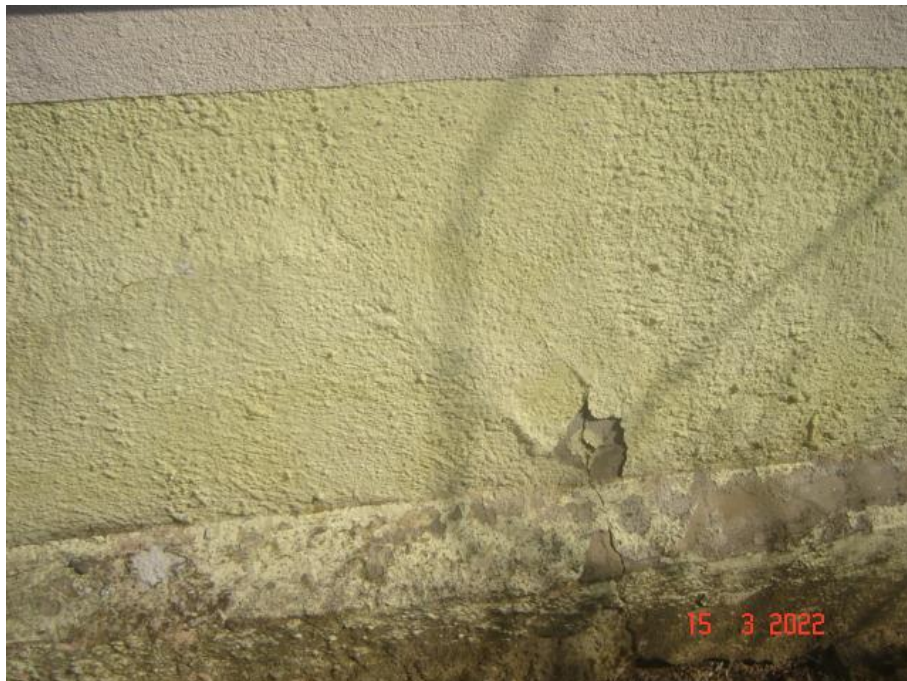
Rysa na ścianie fundamentowej
